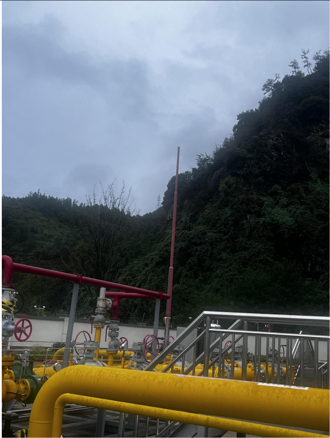
天然气超压放散管
